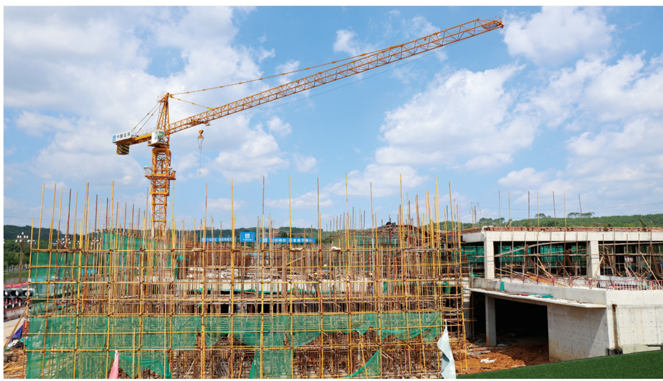
科技城集中发展区地下综合管廊项目是科技城集中发展区基础设施攻坚行动重点项目之一。项目建设内容包括:总长约30.8公里的4条市政道路和地下综合管廊(永青路、龙界路、普明北路西沿线、创业大道西沿线),以及作为配套设施的综合管廊管理中心。该项目目前已完成投资5.8亿元,预计今年完成主体工程进度至50%,完成道路管廊主体和市政道路基础工程。图为建设中的综合管廊项目。(本报记者 蒲涓 摄)
