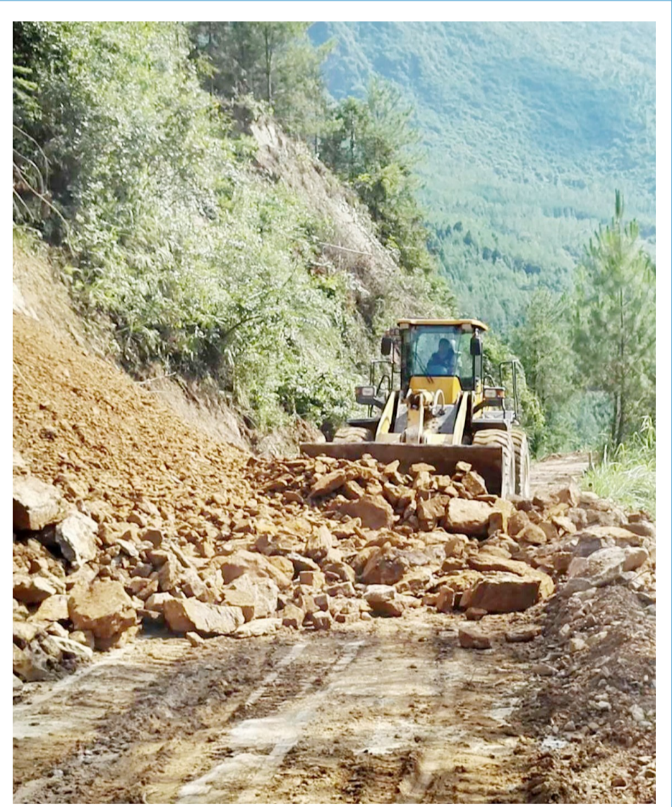
S209线雁门至六合段改建工程正紧张推进。该改建路段长16.3公里，路基宽7.5米。工程于2017年3月开工，计划2018年春节前基本完工。目前已完成投资总额的40%。图为施工现场。（本报记者 肖海梅 摄）
